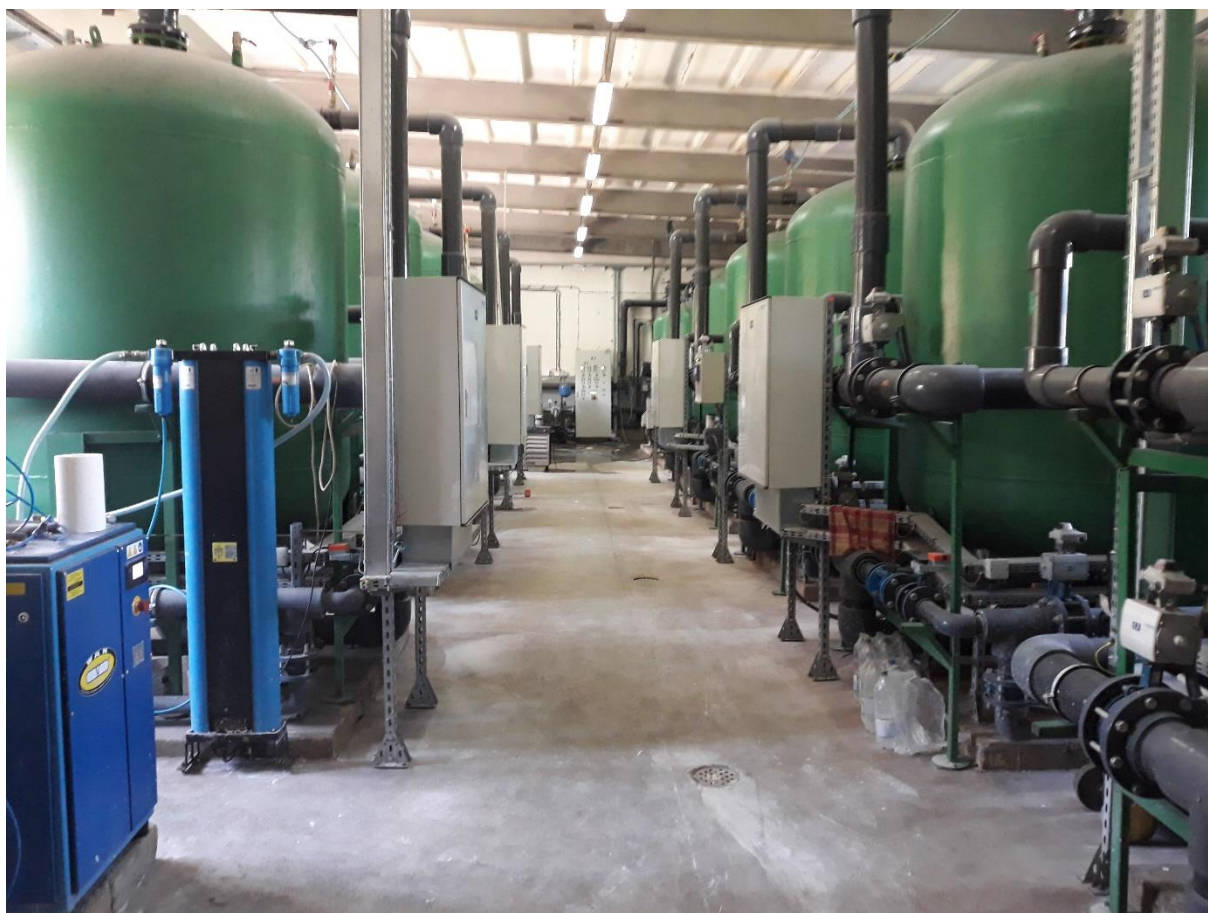
Hydroforownia na stacji uzdatniania wody w Hucie Komorowskiej
