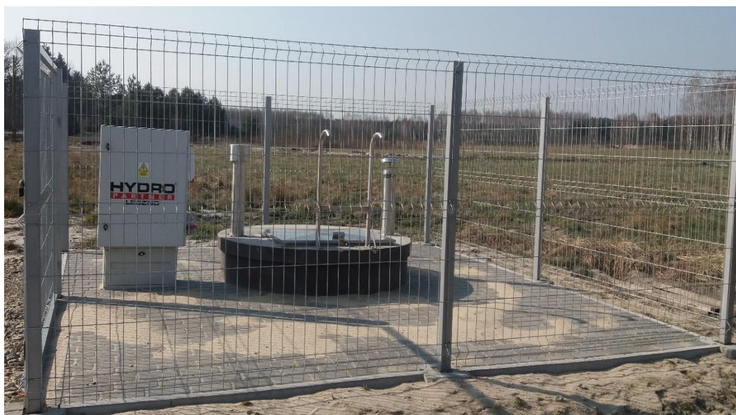
Przepompownia ścieków wybudowana w 2018 r. przy ul. Bachnat
